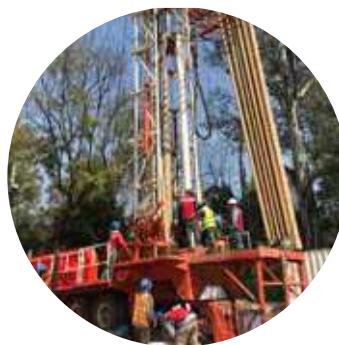
Sistema pozo profundo
