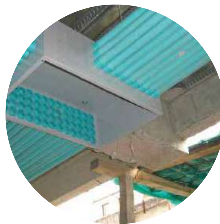
Sistema eléctrico conduit PVC
