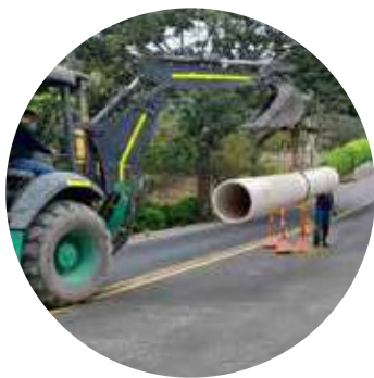
Sistema de acueducto
