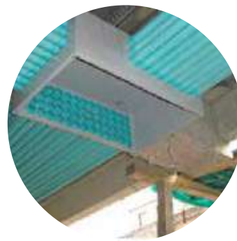
Sistema de telecomunicaciones
