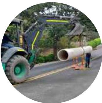
Sistema de acueducto
