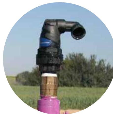
Válvulas de aire ventosas
