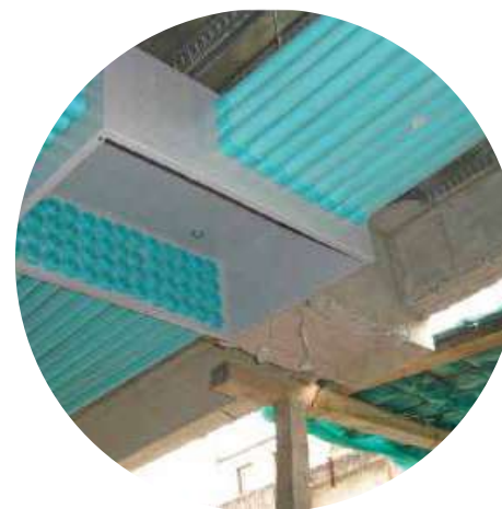
Sistema eléctrico conduit PVC
